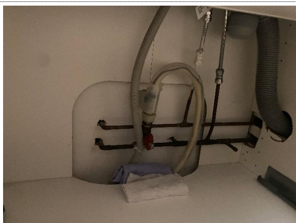
Bilde nr. 19 Tynnveggede kobberør på kjøkken i leilighet
