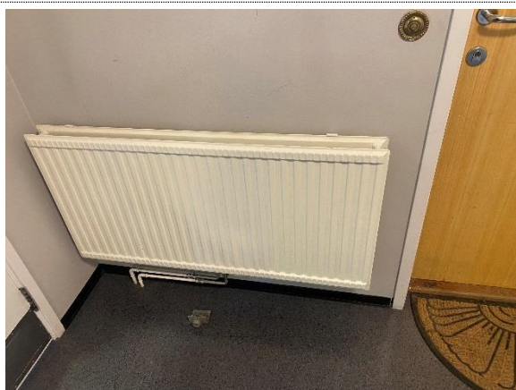
Bilde nr. 27 Radiator i trappeoppgang
