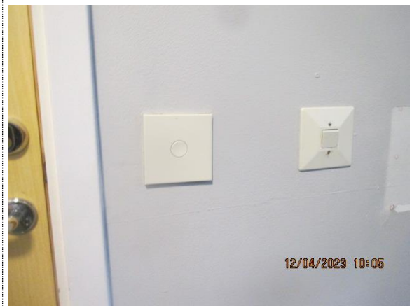
Bilde nr. 44 Det mest av lys styrt med på av bryter.
