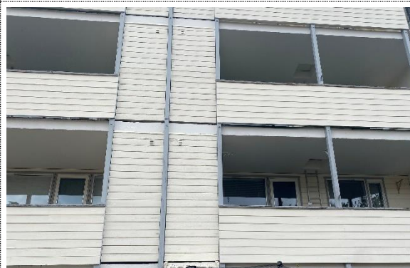
Bilde nr. 34 Ventiler i yttervegg for frisklufttilførsel i blokker
