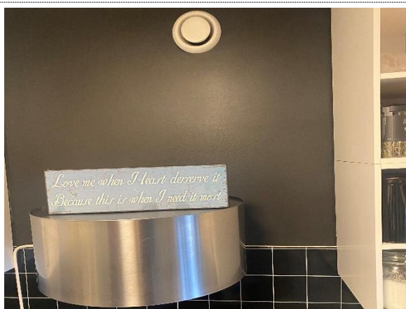
Bilde nr. 31 Kjøkkenhette med fettfilter og avtrekksventiler i vegg
