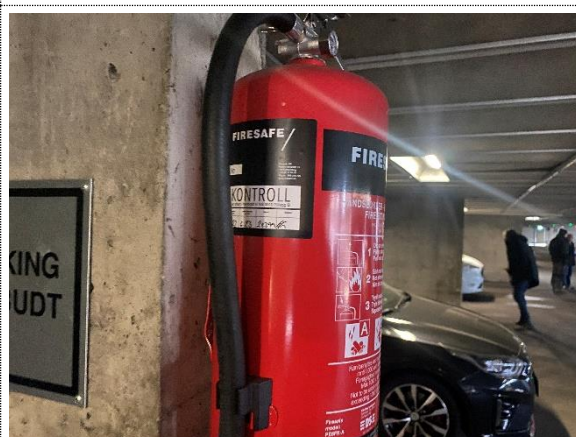
Bilde nr. 30 Håndsløkker med årlig kontroll i garasje
