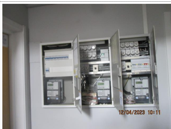
Bilde nr. 39 Undersentraler som ikke er oppgradert må fornyes de neste 10 år.
