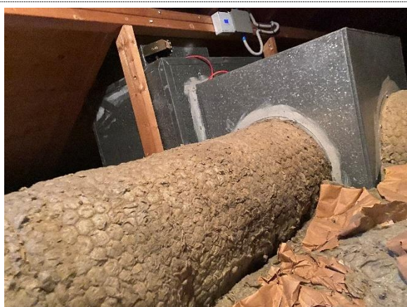
Bilde nr. 35 Avtrekksvifte og isolerte kanaler på loft
