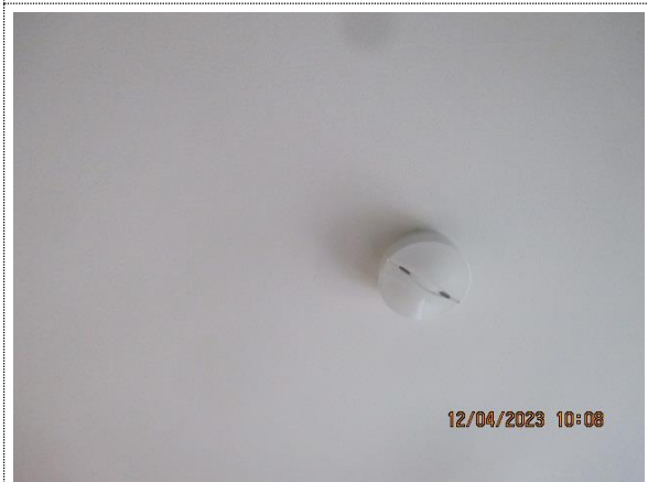
Bilde nr. 48 Byggene må utstyres med heldekkende brannalarmanlegg.
