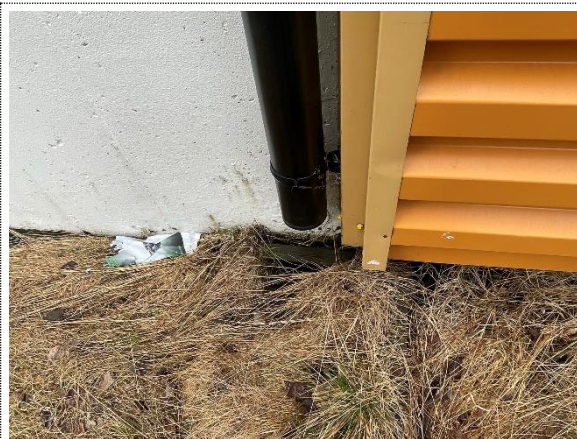
Bilde nr. 14 Forbedre bortledning av regnvann fra nedløpsrørene.
