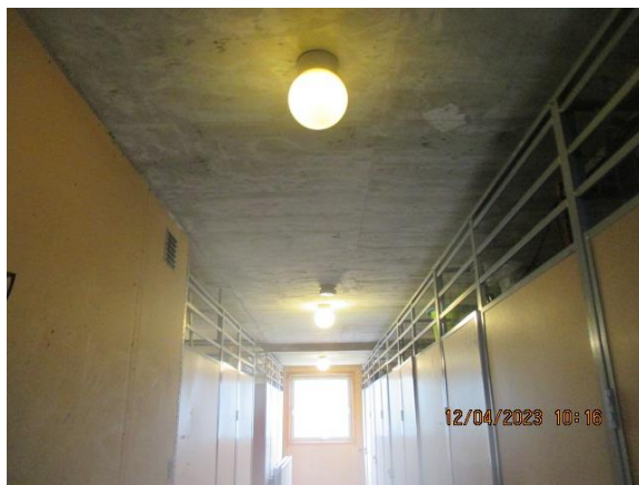
Bilde nr. 43 Bodlys bør skiftes til led-lys med moderne lysstyring.
