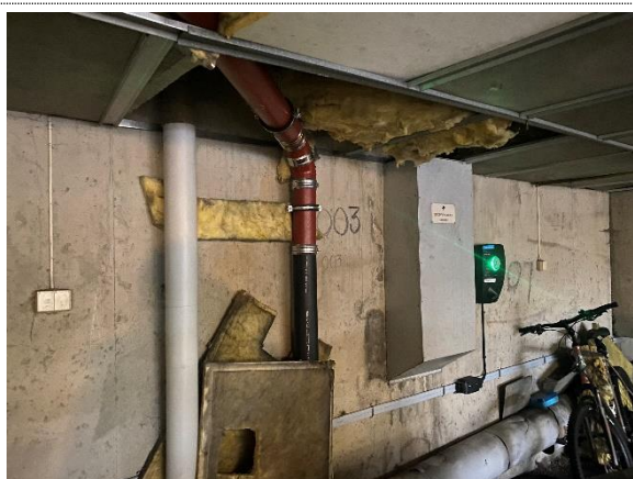
Bilde nr. 25 MA avløpsrør i garasje
