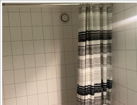
Bilde nr. 32 Avtrekksventil i vegg på bad
