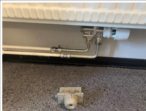
Bilde nr. 28 Nyere termostatstyring
